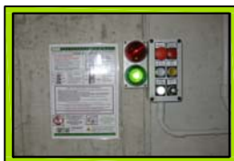
PULSANTIERA AL PIANO
